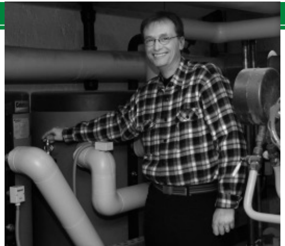
Klaus Schrader von der Abteilung für Haus- und Betriebstechnik in der Warmwasseraufbereitungsanlage am Standort 1.
